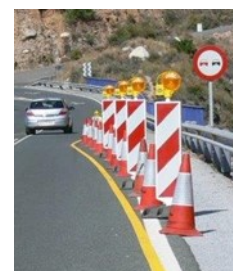
Luces amarillas fijas o intermitentes (sobre balizas de borde provisionales)
