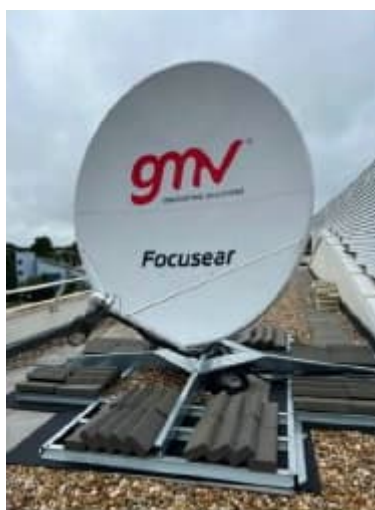
Figura 2. Antena de la red instalada en el edificio de GMV en Boecillo, Valladolid
