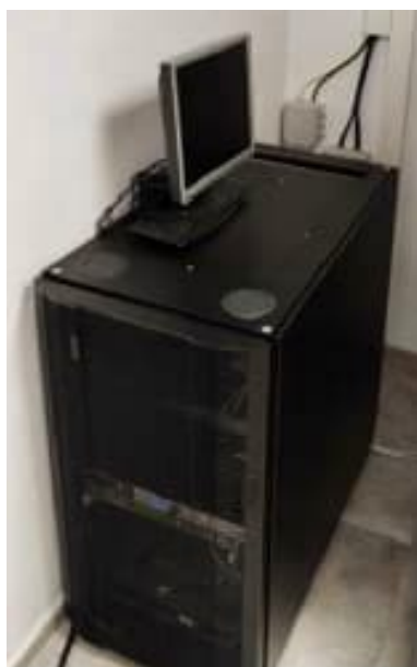
Figure 83. Rack con los equipos del server local
